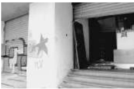
La saracinesca dell'ingresso forzata
